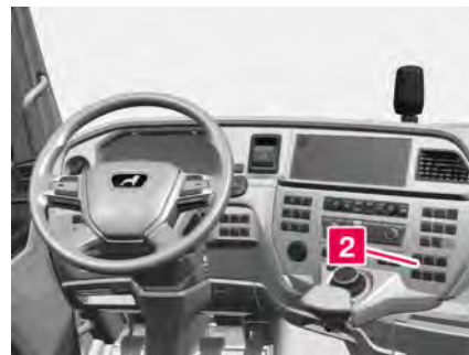
2 Przycisk elektrycznego głównego wyłącznika akumulatora
